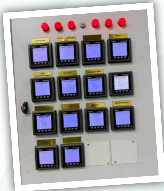
Compteurs électriques connectés installés sur le site SGBIA, assurant un suivi en temps réel et une gestion efficace de l'énergie
